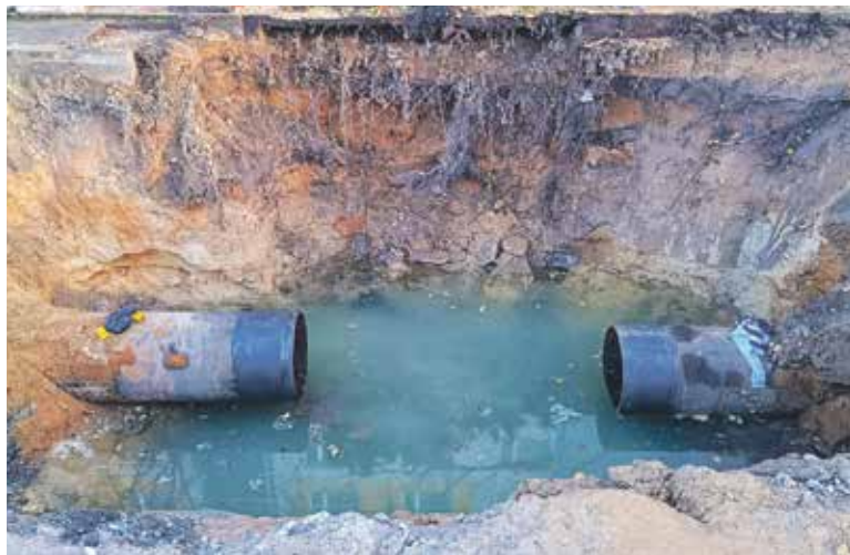
MÍSTO HAVÁRIE vodovodního potrubí.
